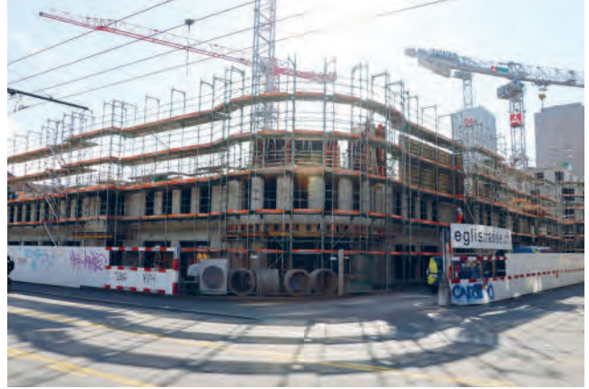
Der markante Haupteingang zum neuen Lighthouse-Palliativzentrum an der Eglistrasse nimmt Formen an.
